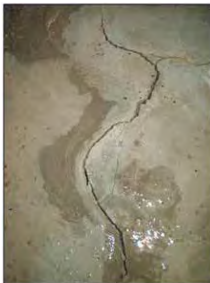
Figura 1. Fissuração por retração.
